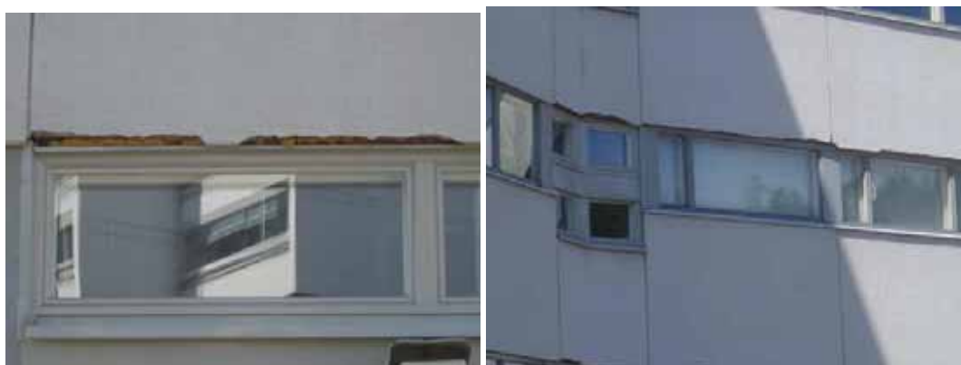
Figura 20 Pihlajamaki, fissuras nos painéis de concreto (Fonte: Autores)
