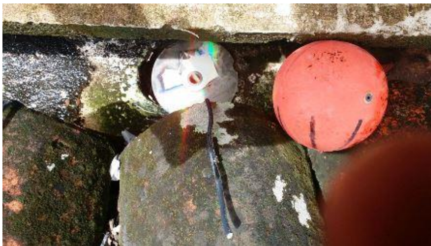
Fig. 18 – Alto risco de colapso numa calha da Igreja da Madre Deus pela quase obstrução da boca do condutor (tudo de queda d'água), devido a um CD e uma bola. Fonte: CECI, set. 2017.
