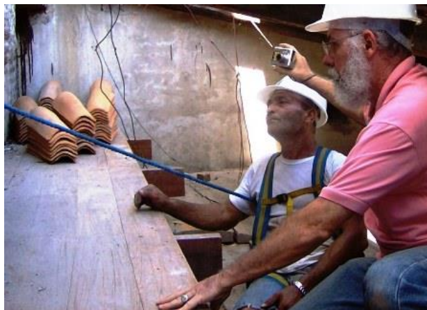
Fig. 17 – Execução de uma rota de inspeção no intradorso do forro na nave lateral esquerda da Basílica da Penha para acessibilidade às inspeções e manutenções periódicas. Fonte: CECI, 2011.
