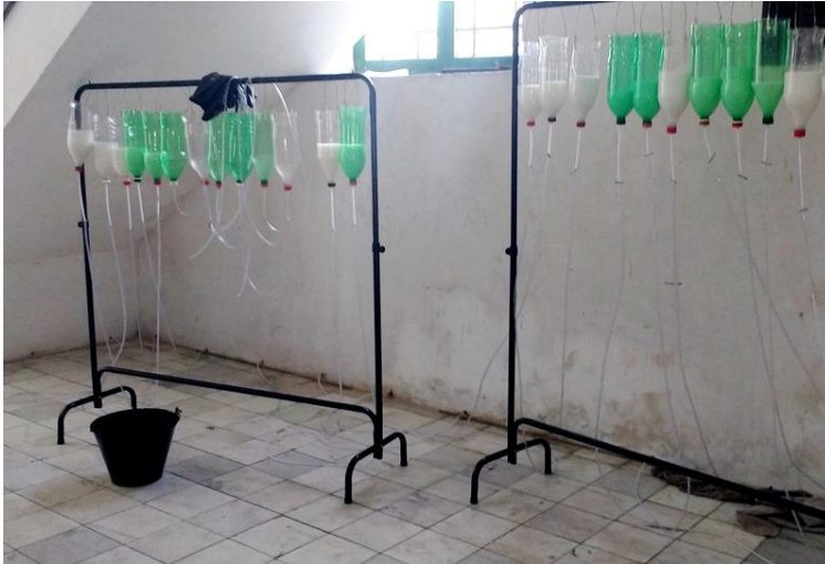
Fig. 8 – Mecanismo improvisado, mas eficaz, para a manutenção periódica da barreira química no combate aos cupins de solo na Igreja da Madre deus.
