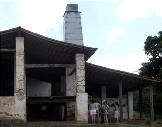
Img. 3 - Aspecto das colunas em alvenaria de tijolos da moita do Engenho Poço Comprido. Fonte: CECI/nov2008
