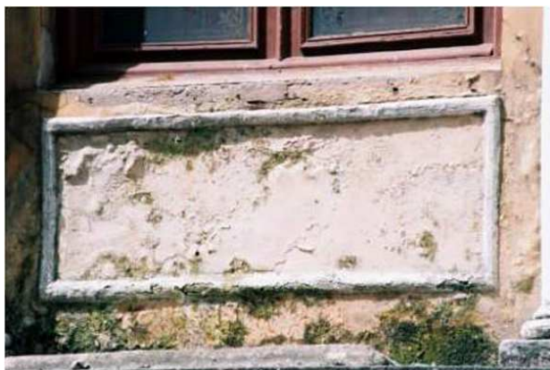
Img. 9 - Arruinamento precoce da fachada de um sobrado, localizado à Rua do Bom Jesus, na cidade do Recife, dois anos após um grande empreendimento de recuperação geral das edificações naquele logradouro histórico. Fonte: CECI/jul2004
