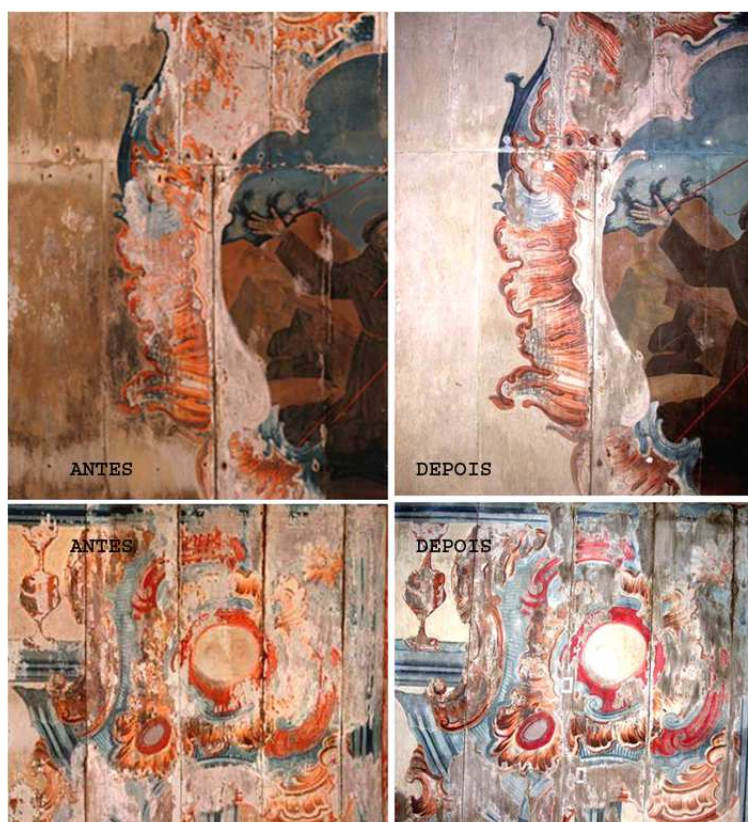
Img. 18 – Detalhes do forro antes e depois das intervenções dentro do critério da mínima intervenção de reintegração da policromia. Fonte: CECI-2008.
