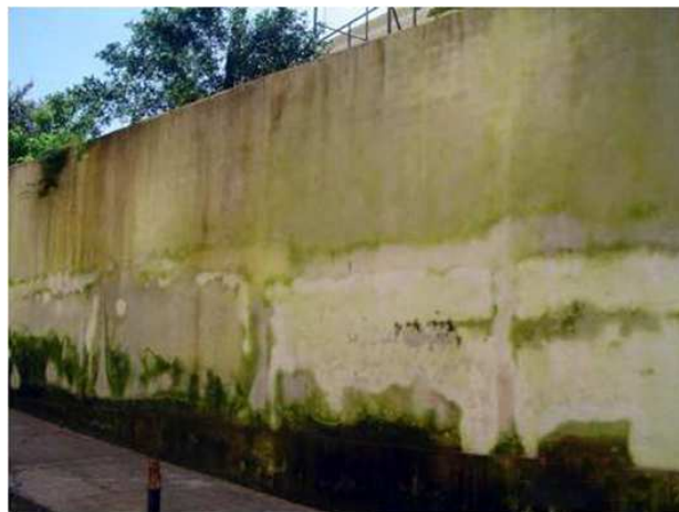
Img. 10 - Rebocos de um muro de uma casa, à Rua de São Bento, em Olinda. Com um mês de execução do restauro já apresentava graves infestações de fungos e proliferação de algas, antes mesmo de ser pintado. Fonte: CECI/nov2007
