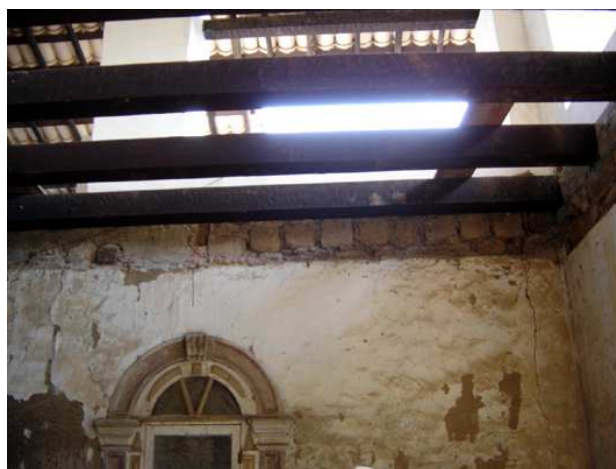
Img. 8 - Consolidação das alvenarias de adobe da capela mor da Igreja de N. Sr a . De Belém (Cachoeira/Bahia) feita em concreto armado, substituindo-se os esteios de madeira que poderiam ter sido encachorrados com samblagens mão-de-amigo. Fonte: CECI / nov2006
