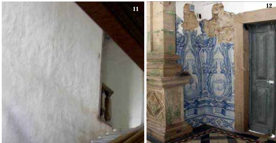
Fig. 11 e 12 – Aspectos da integridade e autenticidade dos rebocos e silhares de azulejos, embora a presença de umidade só esteja afetando as cantarias. Fonte: CECI/maio-2007.
