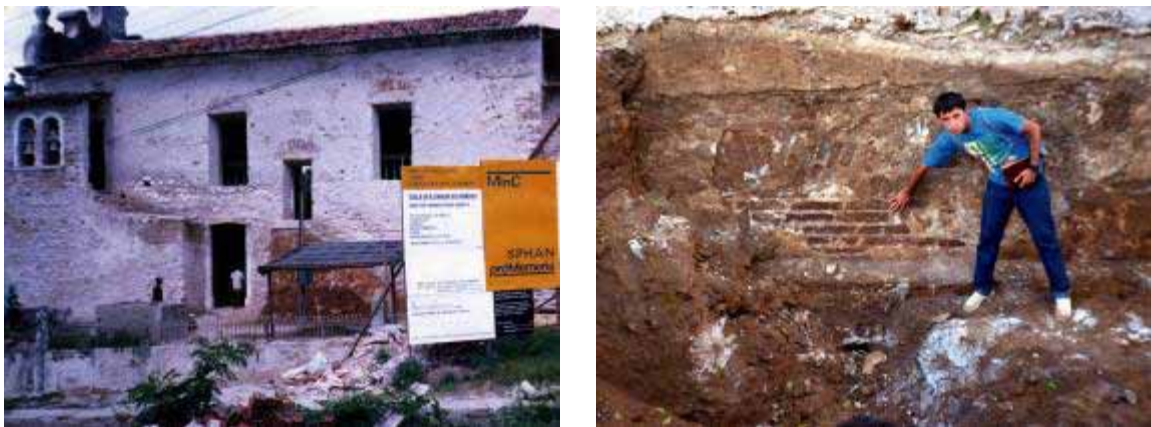
Fig. 3 e 4 - Prospecções arquitetônicas, através a demolição dos rebocos da Igreja de Nossa Senhora dos Remédios (Fernando de Noronha/PE), quando das intervenções de restauro entre 1987, execução da Passos & Tinoco Ltda. O arquiteto Ney de Brito Dantas foi o profissional residente na condução das investigações. Fonte: CECI, Diário de Obras, N. Srª. dos Remédios, nº 01 (1987).
