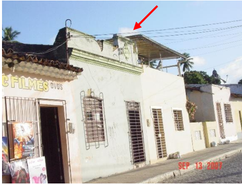
Imagem 1: Modificação de fachada, de volumetria e de material construtivo, com a introdução de telha alumínio
