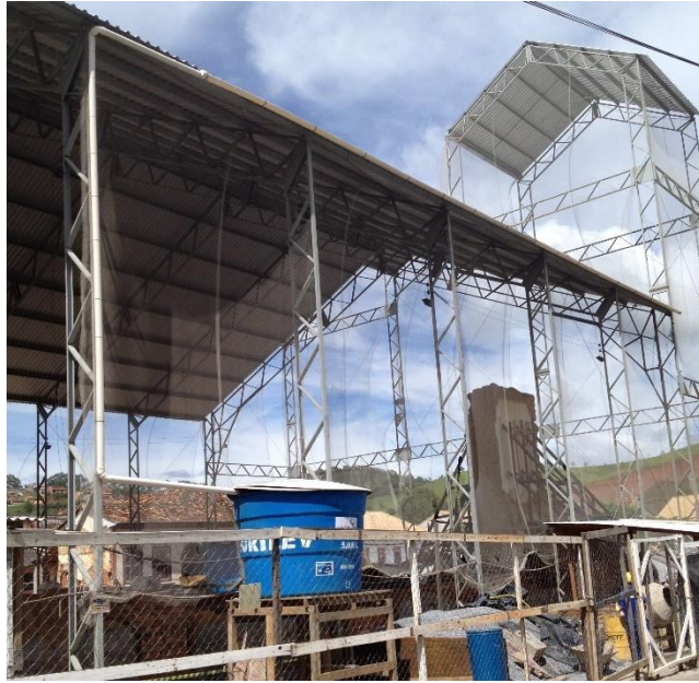
Figura 52 - Exemplo de sistema de captação de águas pluviais pela cobertura provisória Foto tirada durante as obras de reconstrução e restauração da Igreja Matriz de São Luís de Tolosa, em São Luiz do Paraitinga/SP
