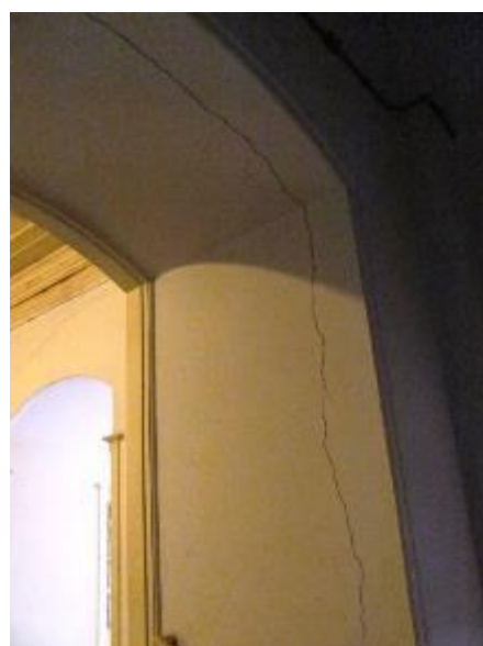
Figura 38 - Rachaduras nas paredes superiores
