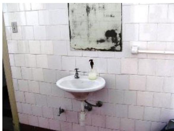
Figura 26 - Sanitário sem acessibilidade
