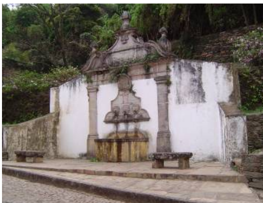
Foto 02: Pátina sobre a superfície de uma fachada, Ouro Preto-Brasil, 2005. Fonte: Acervo dos autores.
