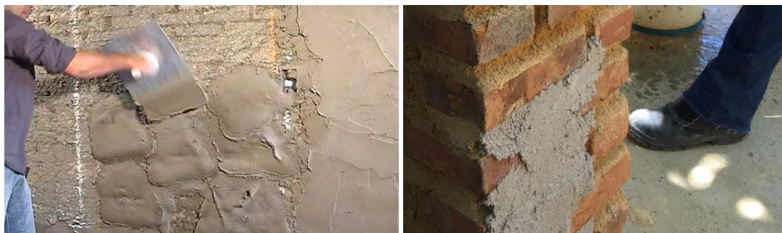
Fig. 8 e 9 – Parede de reboco sendo estucada com uma trolha moderna. A argamassa não é lançada pela colher, mas pressionada (8). Argamassa do reboco ancorada nos frisos deixados
